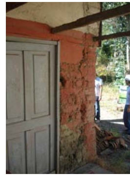
Fotografía 3. Grieta vertical en esquina de muro.
