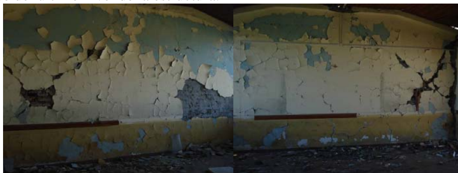
Fotografía 15. Daños en muros del último nivel.
