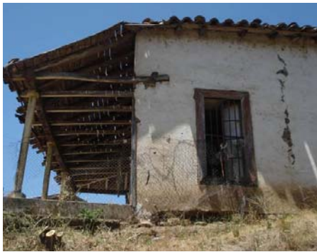
Fotografía 2. Grieta vertical en encuentro de muros.
