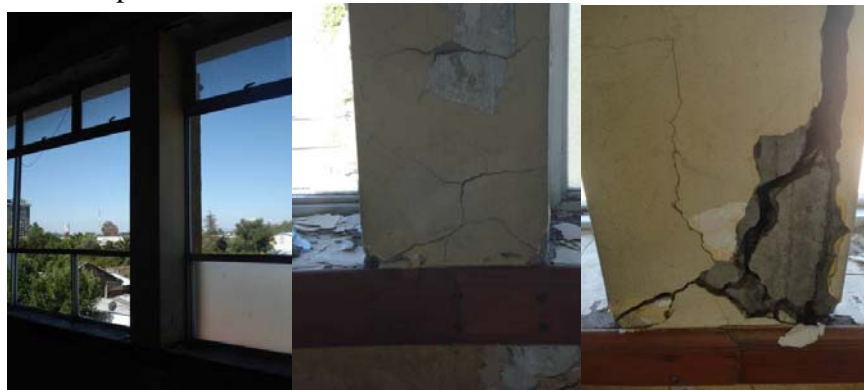
Fotografía 17. Falla en columnas.
