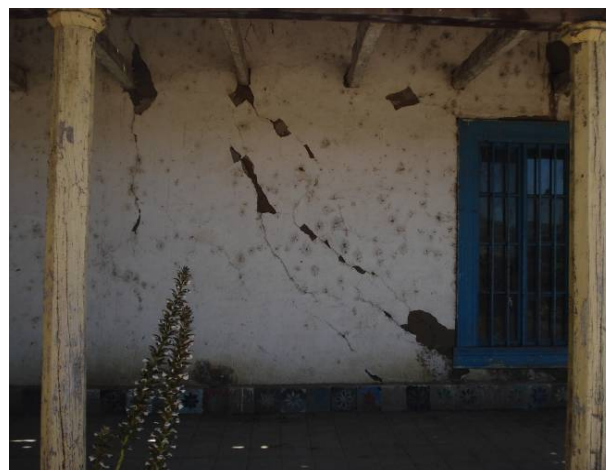
Fotografía 5. Grieta diagonal en esquina inferior del vano. (Escuela El Emboque)
