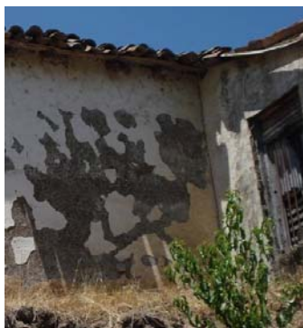
Fotografía 6. Fisura vertical en encuentro de muros.
