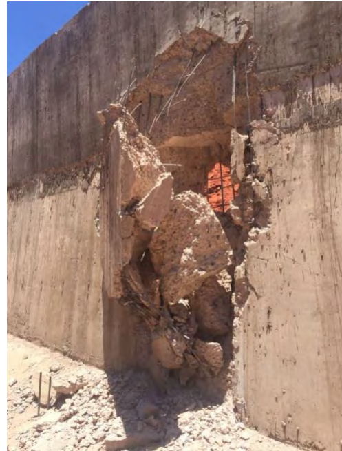
Figura 10.b. Vista del efecto de rotura ocasionado por la caída de bloques sobre el trasdós del muro
