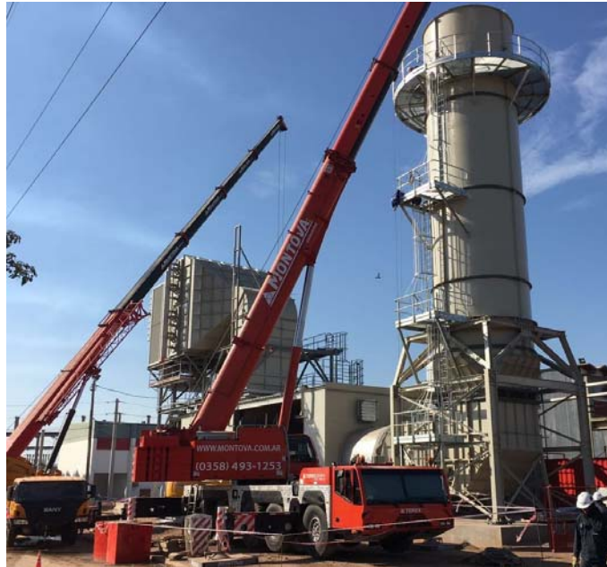
Figura 2. Turbina de Gas e instalaciones complementarias
